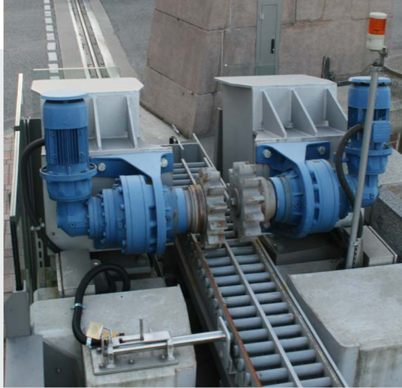
Hochwasserschutz in der Hamburger Speicherstadt: Bei Sturmflut schließen die motorgetriebenen Schiebetore an der Kornhausbrücke.
